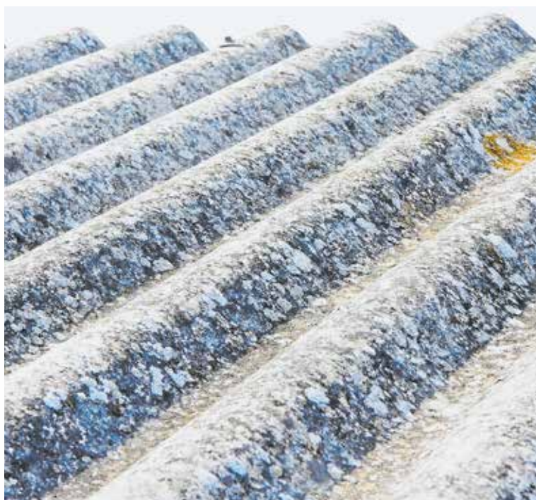
Für die Arbeit mit Asbestzement ist eine spezielle Sachkunde erforderlich, die bei Kursangeboten erworben werden kann. Foto: Francesco Scatena/Fotolia
