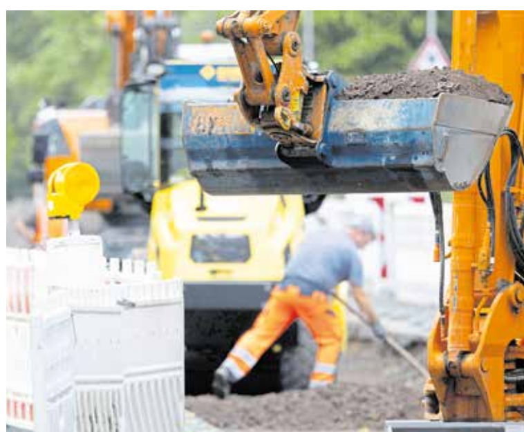
Trotz voller Baggerschaufel: Für das Handwerk ist das MaB jetzt voll. Kammerpräsident Christof Burger fordert einen klaren Kurs in der Wirtschaftspolitik. Foto: bilderstoecken/AdobeStock
